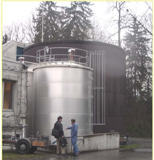
Cuve de stockage des graisses et digesteur
